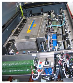
Equipements électriques de conversion de l'énergie
